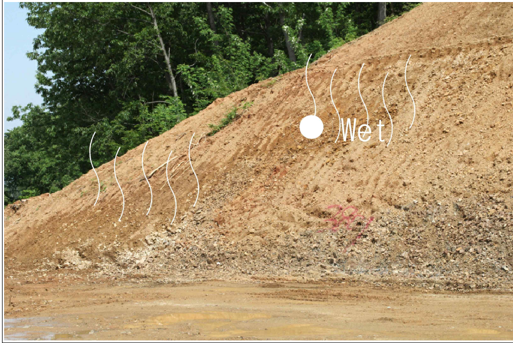
【그림 18】 A 영역 상세사진 (지하수 유출 및 토사유실)
