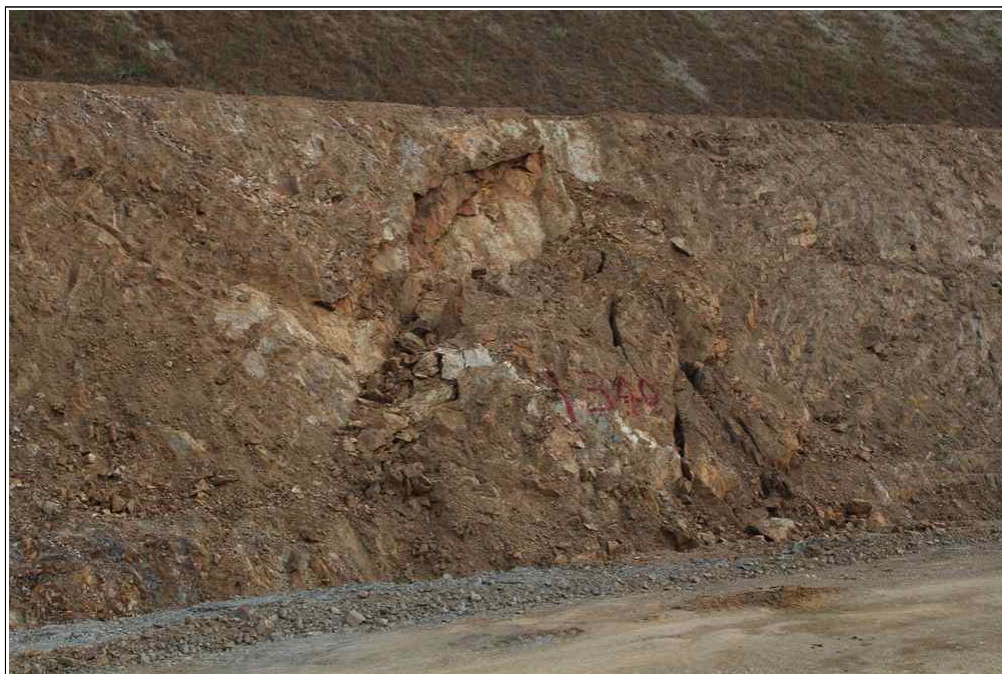
【그림 8】 붕괴부 (STA.9+340)
