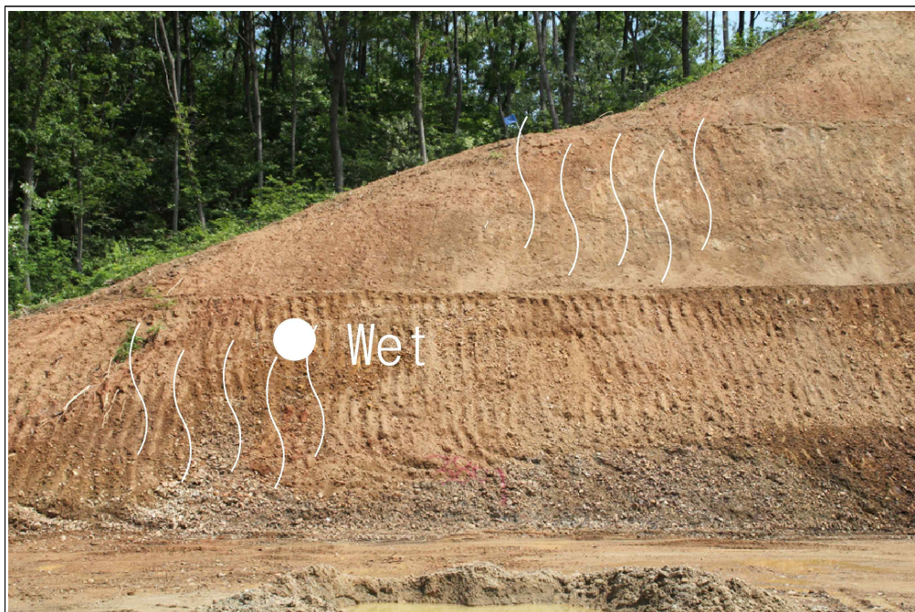
【그림 17】 A 영역 상세사진 (지하수 유출 및 토사유실)
