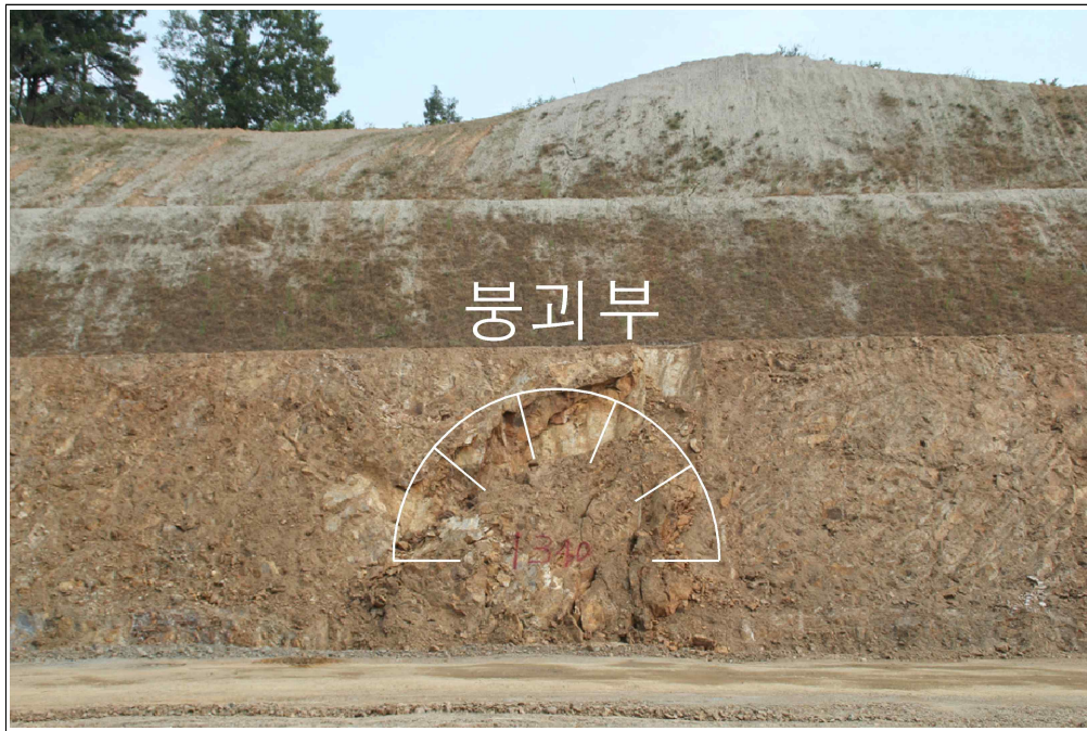
【그림 7】 붕괴부 (STA.9+340)
